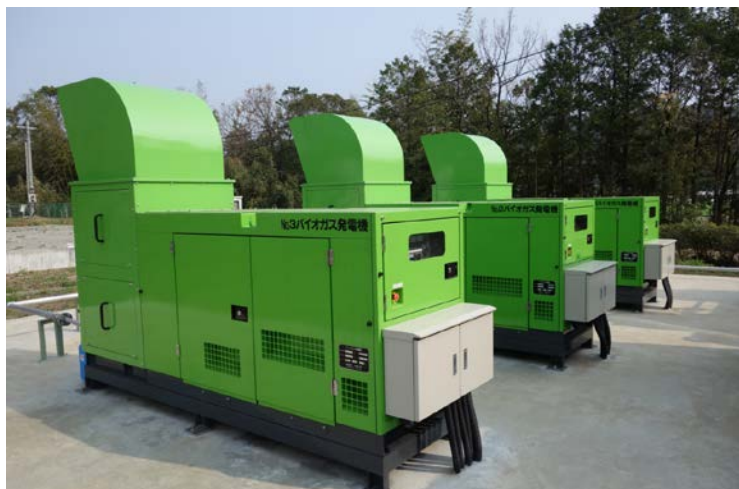
バイオ発電機
