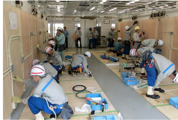
電気配線研修
