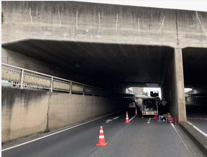
カルバート剥落対策工事 (超薄膜スケルトンはく落防災コーティング)
